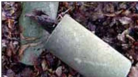
Ebenfalls Höhe Quellennweg: Betonsokkel mit verrosteten Pfostenresten, scharfkantig und daher gefährlich für Mensch und Tier. Diese liegen nun schon seit Monaten im Graben, hier fühlt sich niemand verantwortlich und so wird dieser Anblick den Spaziergänger wohl noch länger »erfreuen«.
